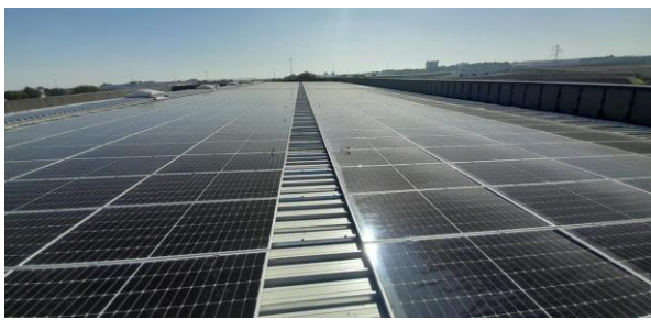
STABILIMENTO BUS GRUPPO STENLANTIS DI FOGGIA
